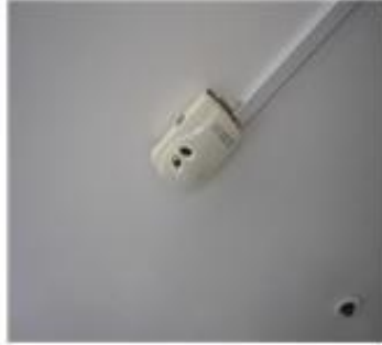
▲ 가스누설경보기의 탐지부가 설치된 사례
