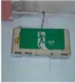
▲ 유도등이 부식 되어 점등되지 않는 경우
