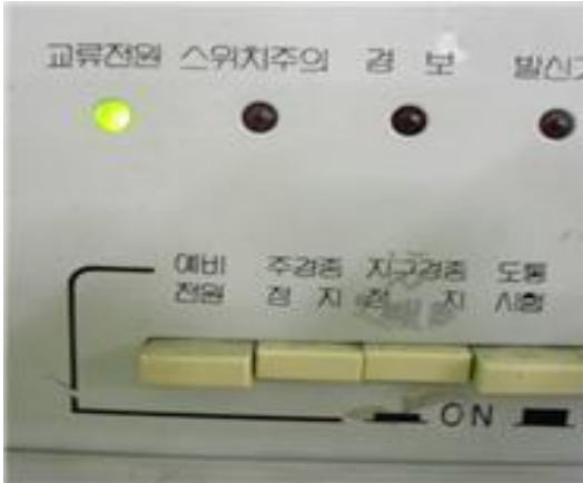
▲ 수신기 정지버튼을 누른 상태로 방치한 경우
