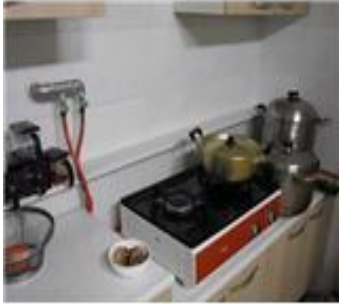
▲ 가스누설경보기가 미설치된 경우
