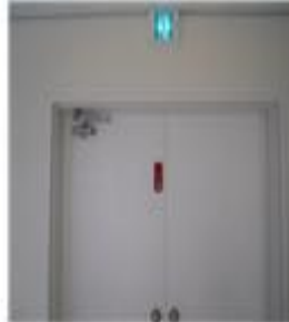
▲ 피난구 유도등이 올바르게 설치된 경우
