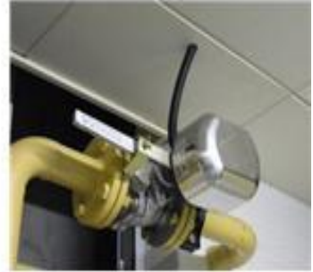
▲ 가스누설경보기의 차단밸브가 설치된 사례
